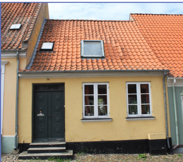
Eksempel på et for stort og utilpasset tagvindue.
